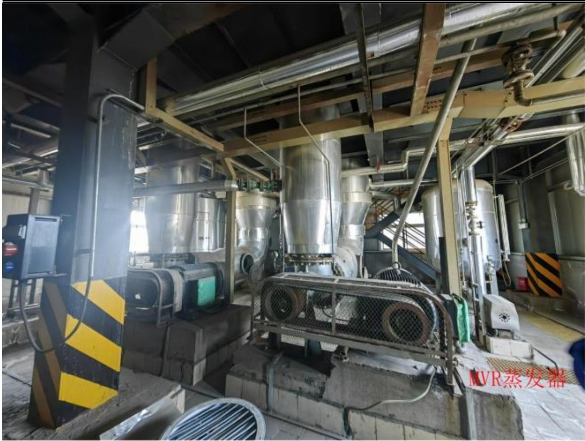
图 4.1.2-1 水处理设施现场照片
