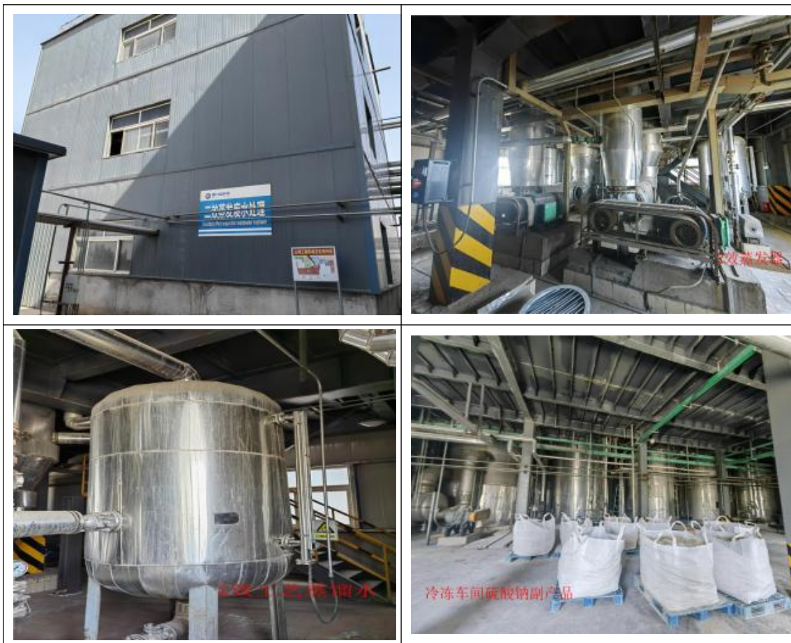
图 3.5.1-1 车间处理设施照片
